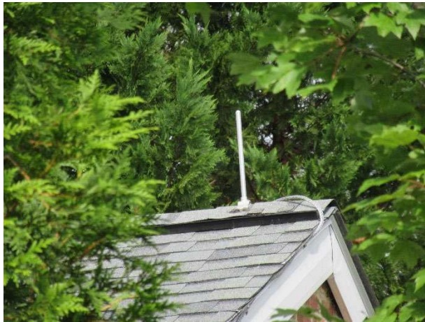
Lightning rod overview
